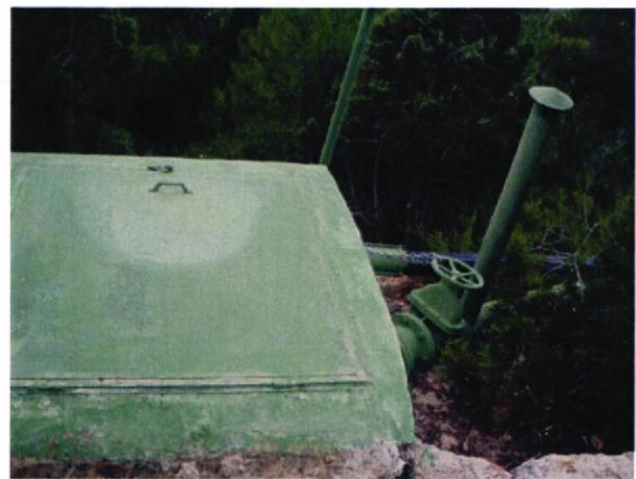
Foto 4. Arqueta de salida (Man. Barranco La Canal), Quesada.
