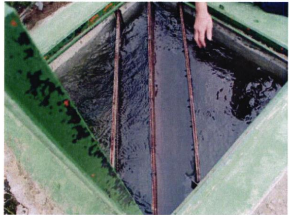
Foto 6. Arqueta de control (Man. Barranco la Canal), Quesada.
