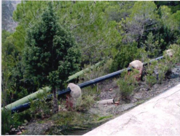
Foto 5. Tuberías de salida hacia Huesa y pedanías de Quesada.
